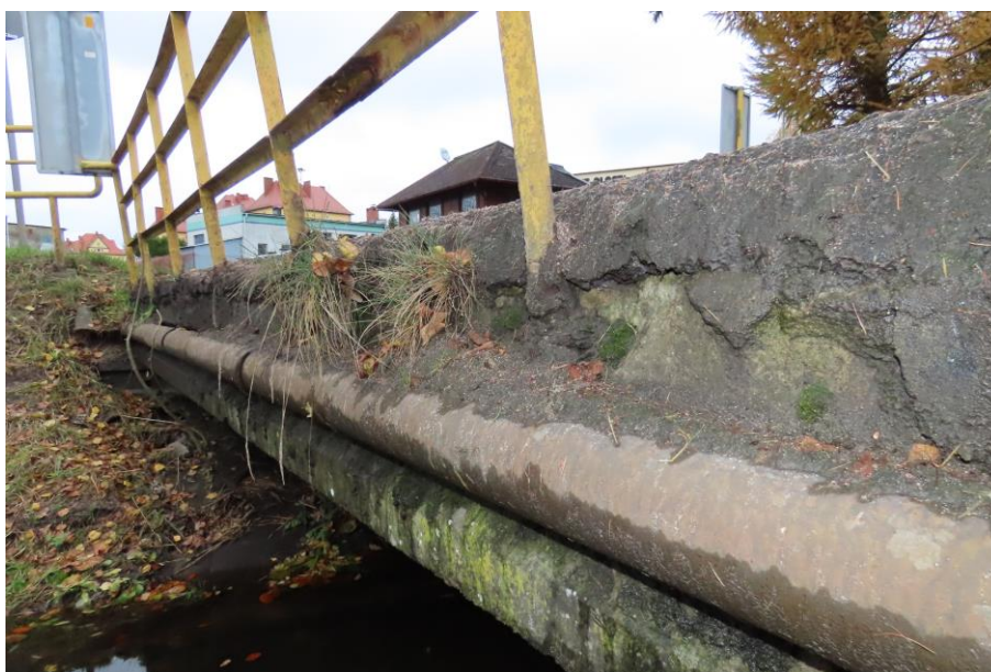
Fot. 2.6. Brak gzymsów od strony górnej wody: na bokach ustroju nośnego występują zanieczyszczenia, wegetacja roślin i glonów, zawilgocenia i ubytki betonu – typowe uszkodzenia bocznej powierzchni ustroju nośnego
