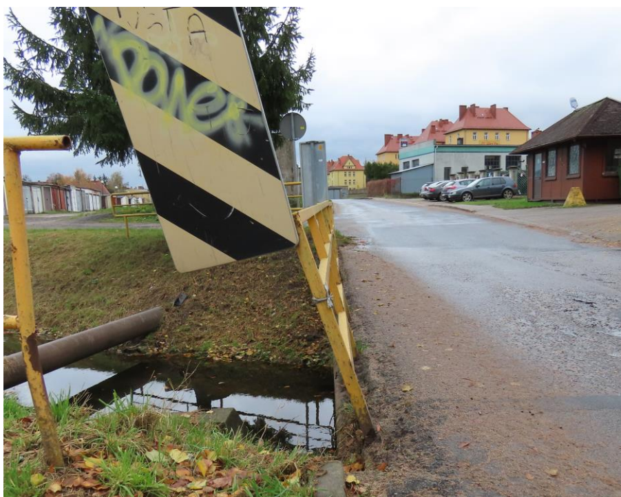
Fot. 2.4. Deformacja balustrady od strony górnej wody, poręcz odchylona 25 cm od pionu
