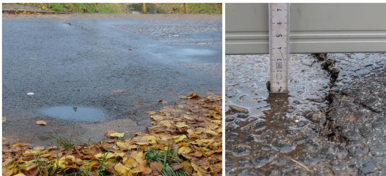
Fot. 2.2. Najazd na obiekt od strony prawobrzeżnej: lokalne zapadnięcia nawierzchni do 35 mm oraz zarysowania nawierzchni na najeździe na obiekt
