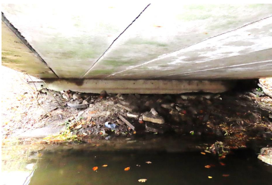
Fot. 2.12. Koryto rzeki pod mostem: zanieczyszczenia i ubytki umocnienia i przemieszczenia terenu koryta pod mostem – typowe uszkodzenia
