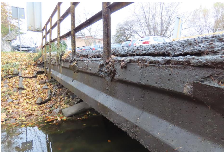
Fot. 2.7. Brak gzymsów od strony dolnej wody: na bokach ustroju nośnego występują zanieczyszczenia, wegetacja roślin i glonów, zawilgocenia i ubytki betonu – typowe uszkodzenia bocznej powierzchni ustroju nośnego
