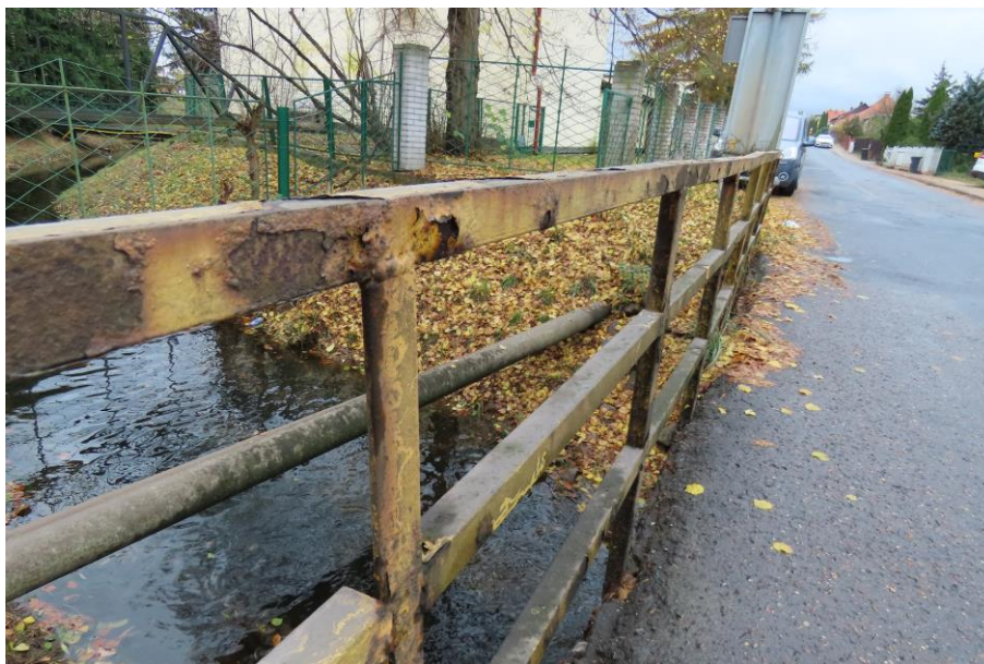
Fot. 2.3. Balustrada na obiekcie: zanieczyszczenia i uszkodzenia powłoki ochronnej w wyniku postępującej korozji, wysokość balustrady 95 cm – typowe nieprawidłowości
