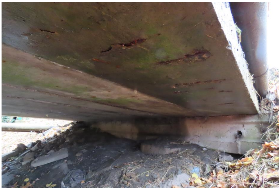
Fot. 2.9. Zacieki, zarysowania, ubytki otuliny i korozja zbrojenia oraz wegetacja glonów - typowe uszkodzenia skrajnych dźwigarów powodowane zciekami wody z powodu braku gzymsów
