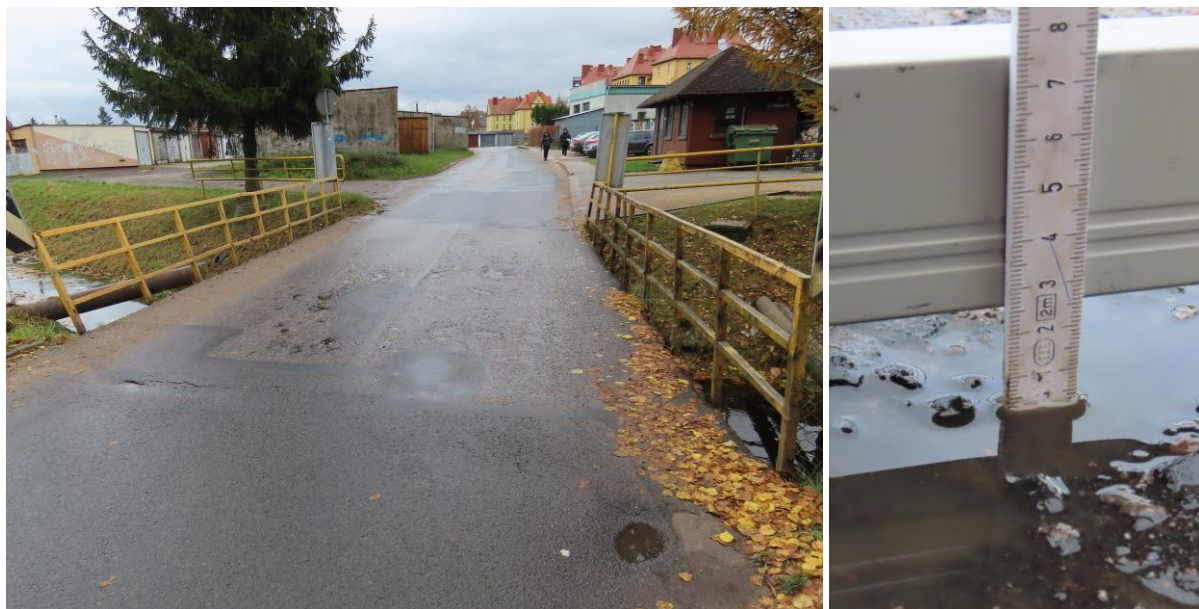
Fot. 2.1. Nawierzchnia na obiekcie: drobne ubytki i nierówności do 25 mm
