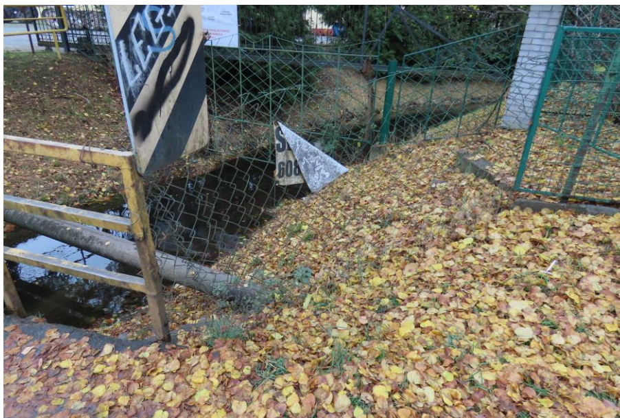
Fot. 2.5. Skarpa po stronie prawobrzeżnej, brak balustrady, zabezpieczenie skarpy w postaci siatki ogrodzeniowej
