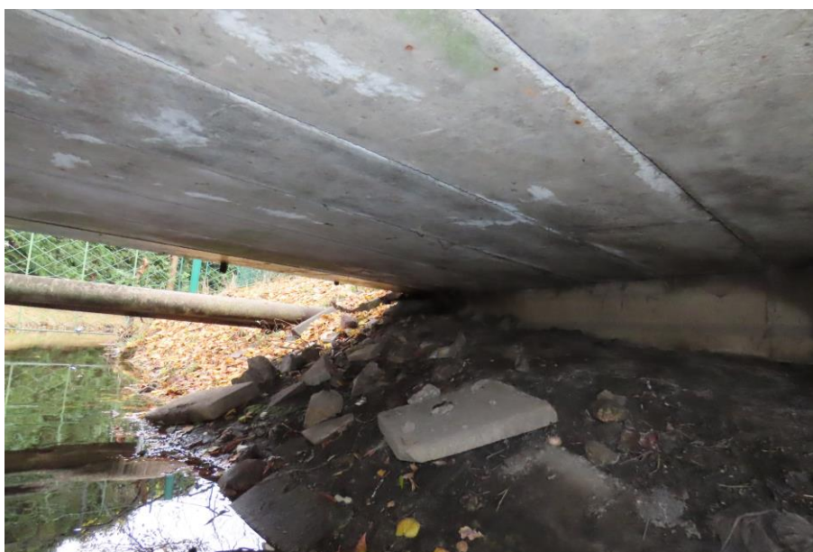
Fot. 2.10. Dźwigary środkowej części ustroju nośnego: drobne wykwyty korozji zbrojenia, lokalnie wegetacja glonów i wykwyty rozpuszczalnych składników betonu, co świadczy, że przy intensywnych oraz długotrwałych opadach występują przecieki przez nawierzchnię
