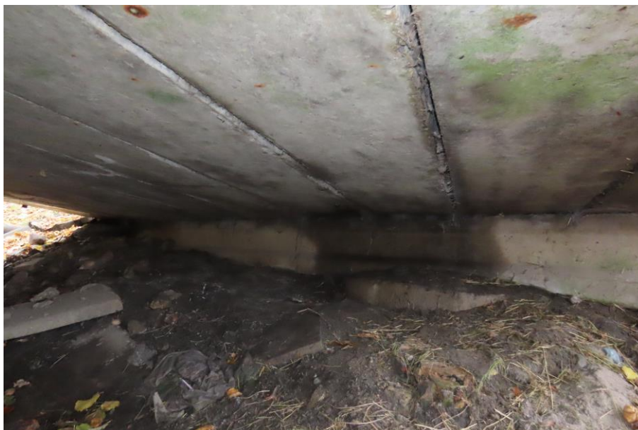
Fot. 2.11. Podpora w postaci dźwigara ułożonego na studniach prefabrykowanych: zacieki na podporze świadczące o nieszczelności i przeciekach wody opadowej przez nawierzchnię na najzjazdach na obiekt
