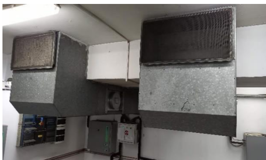
Zdjęcie nr 6 – wyrzutnie z pomieszczenia agregatów chłodniczych
