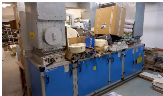
Zdjęcie nr 7 – wentylatory obsługujące pomieszczenie agregatów
