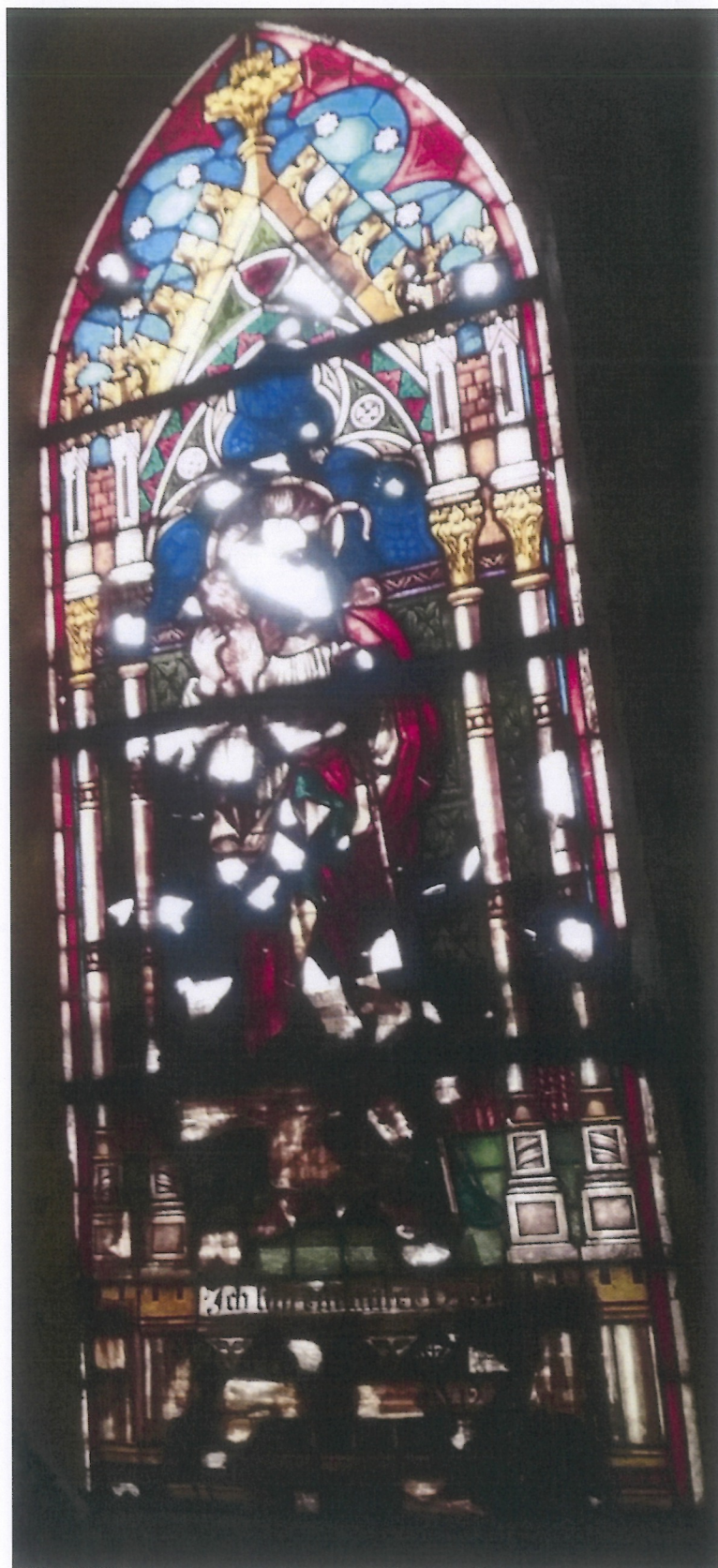
Fot. 119 (wyk. W. Tomaszewski): Stan zachowania witrażu z przedstawieniem Jezusa Dobrego Pasterza (widok od strony wewnętrznej – stan z grudnia 2019 r.)
