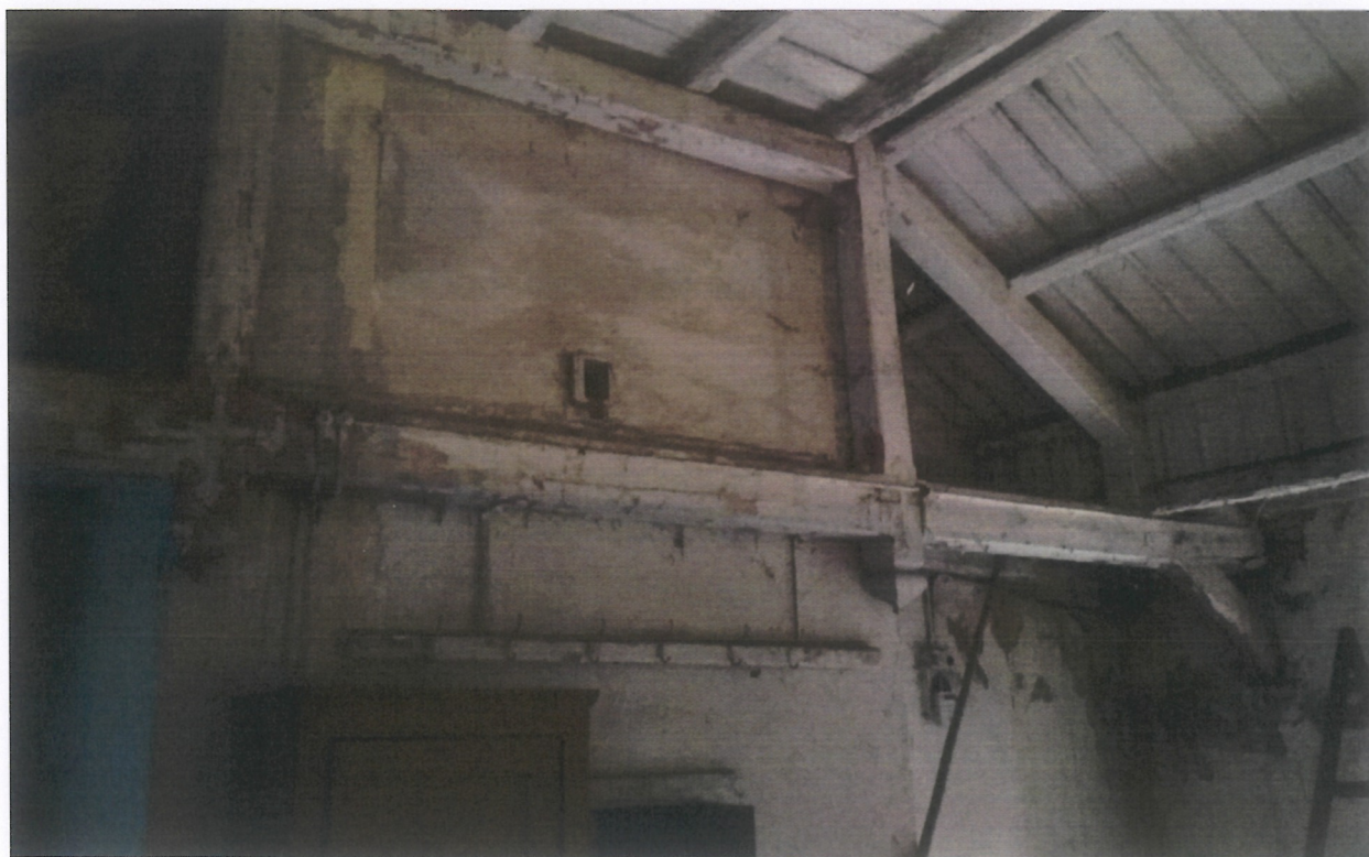
Fot. 78 (wyk. W. Tomaszewski): Widok stanu zachowania ściany tylnej za emporą – z wejściem na wieżę dzwonną.
