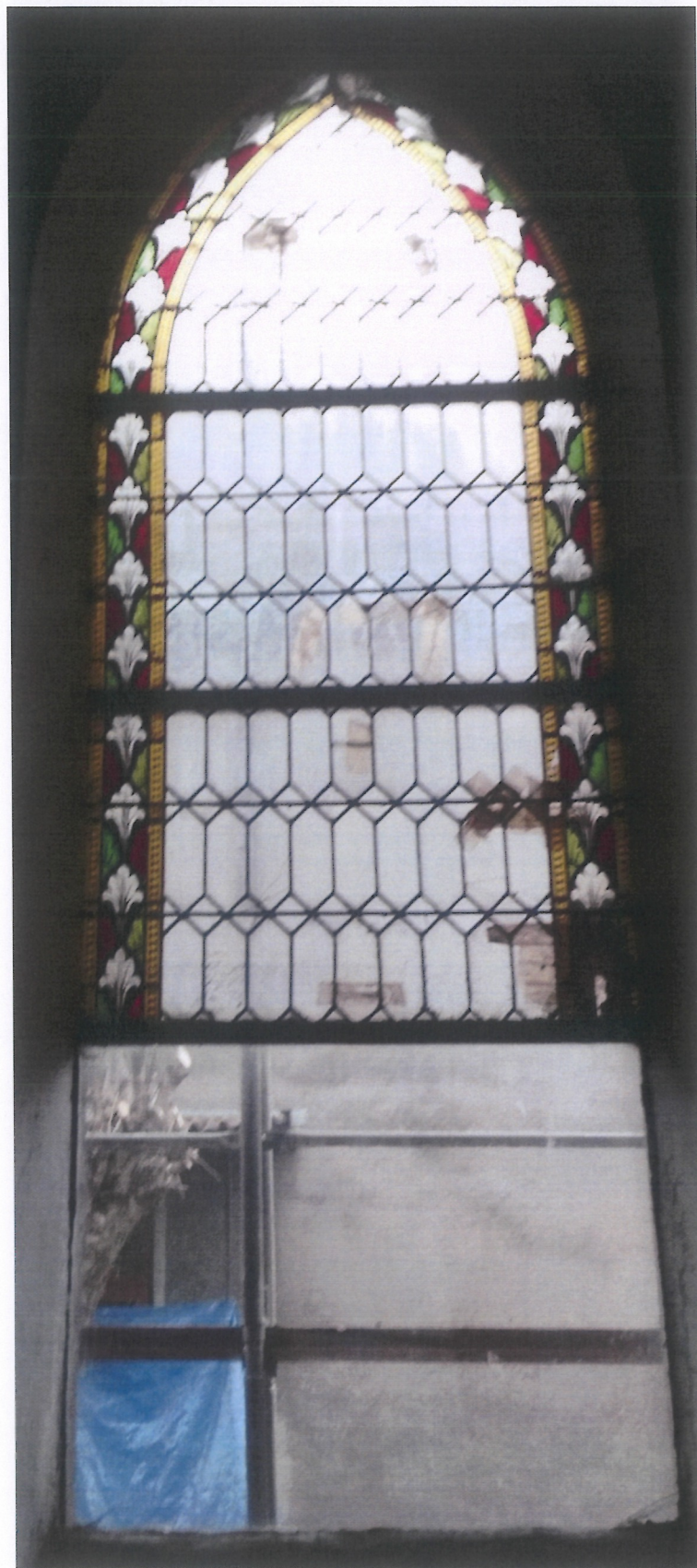
Fot. 128 (wyk. W. Tomaszewski): Stan zachowania witrażu w oknie na elewacji południowej (od wewnątrz).
