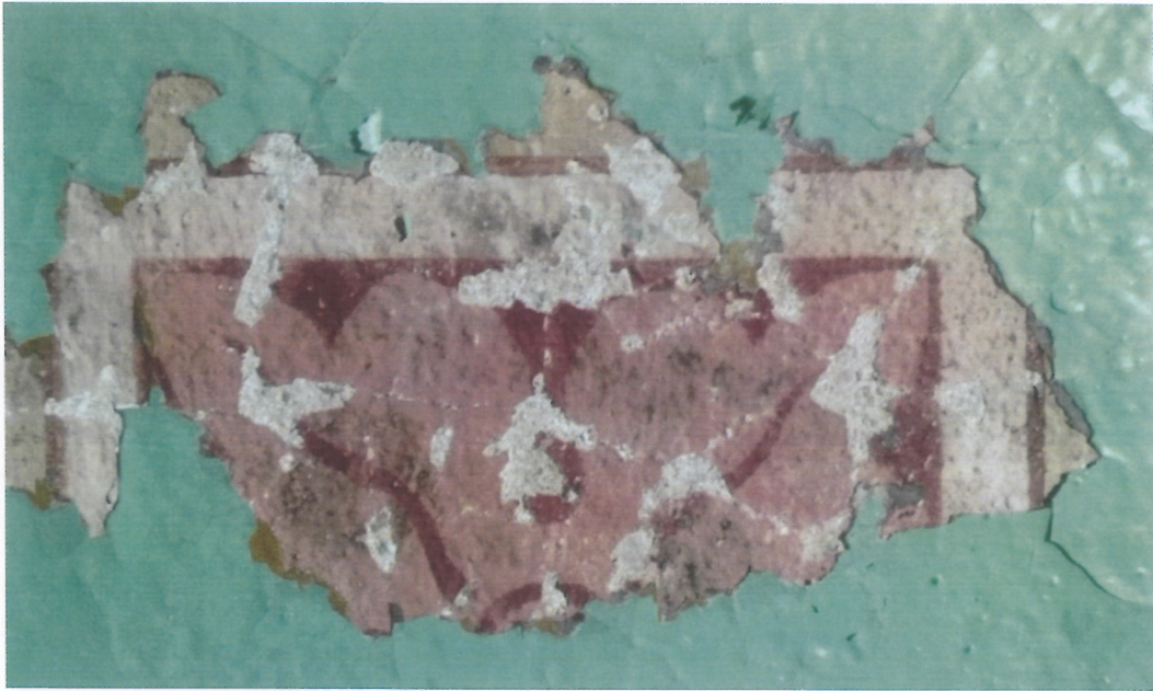
Fot. 105 i 106 (wyk. W. Tomaszewski): Odkrywki szablonych malatur pod olejnymi warstwami seledynowej lamperii. Są to powierzchnie ścian prezbiterium do wysokości parapetów okiennych (ok. 150cm).
