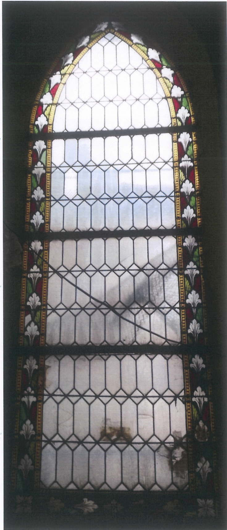
Fot. 130 (wyk. W. Tomaszewski): Stan zachowania witrażu w oknie na elewacji południowej (od wewnątrz).
