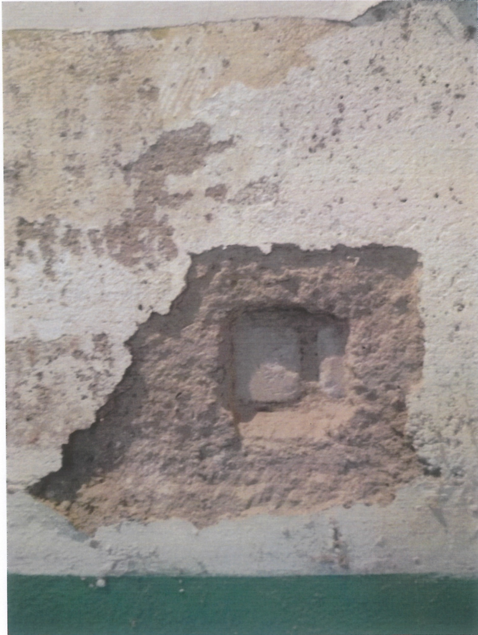
Fot. 85(wyk. W. Tomaszewski): Odkrywka warstw malarskich oraz tynku na południowej ścianie nawy.
