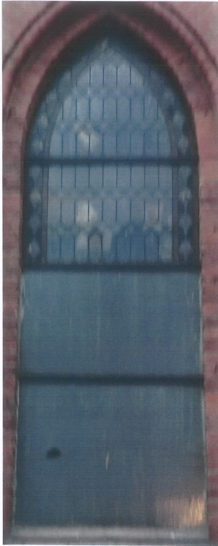
Fot. 131 (wyk. W. Tomaszewski): Stan zachowania witrażu w oknie na elewacji północnej (od zewnątrz).
