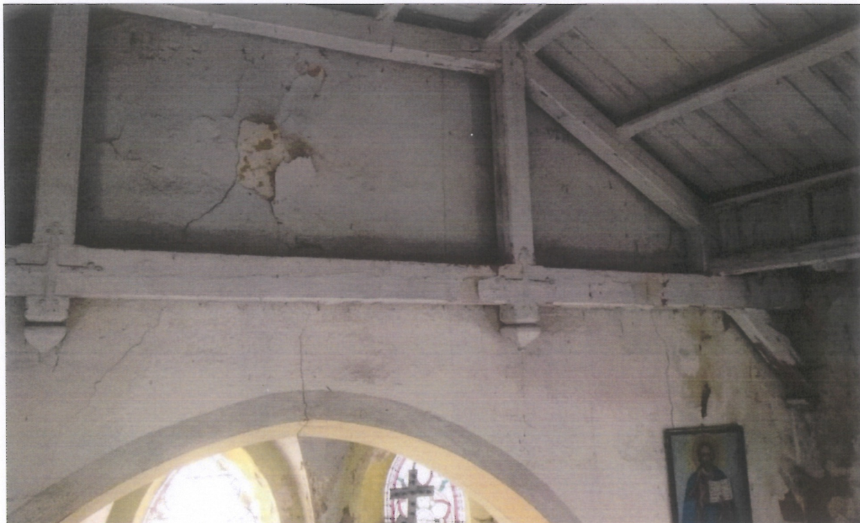
Fot. 77 (wyk. W. Tomaszewski): Widok stanu zachowania powierzchni ściany ponad łukiem tęczowym.
