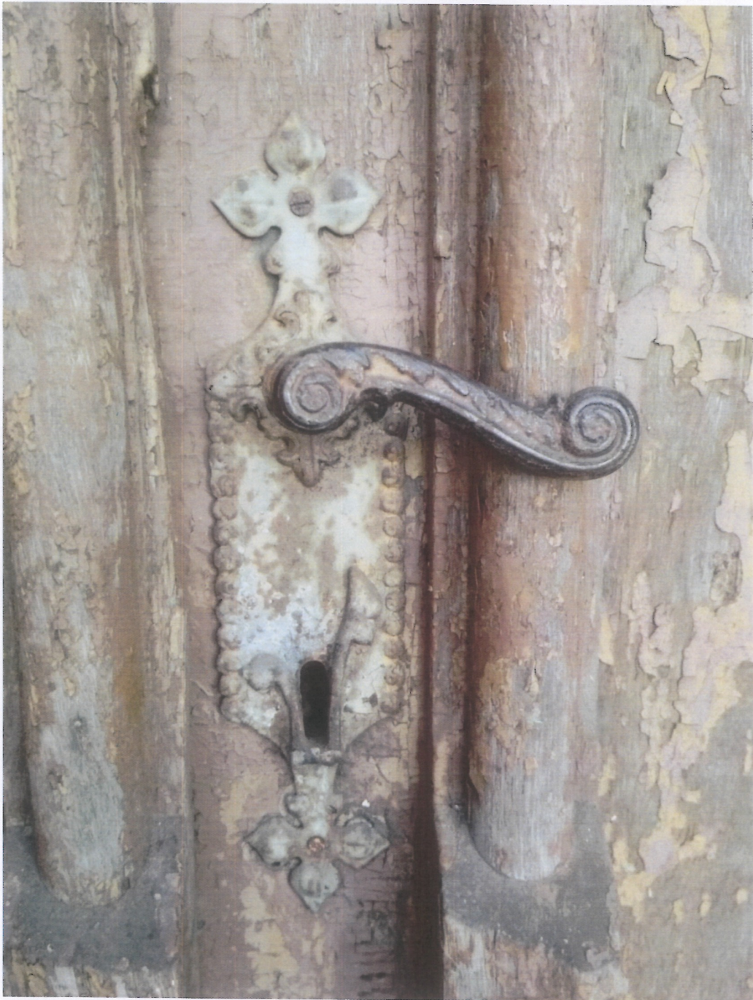
Fot. 69 (wyk. W. Tomaszewski): Widok stanu zachowania oryginalnej żeliwnej klamki oraz szyldu. Widoczne są również pozostałości farby olejnej odspajającej się od podłoża drewnianego.
