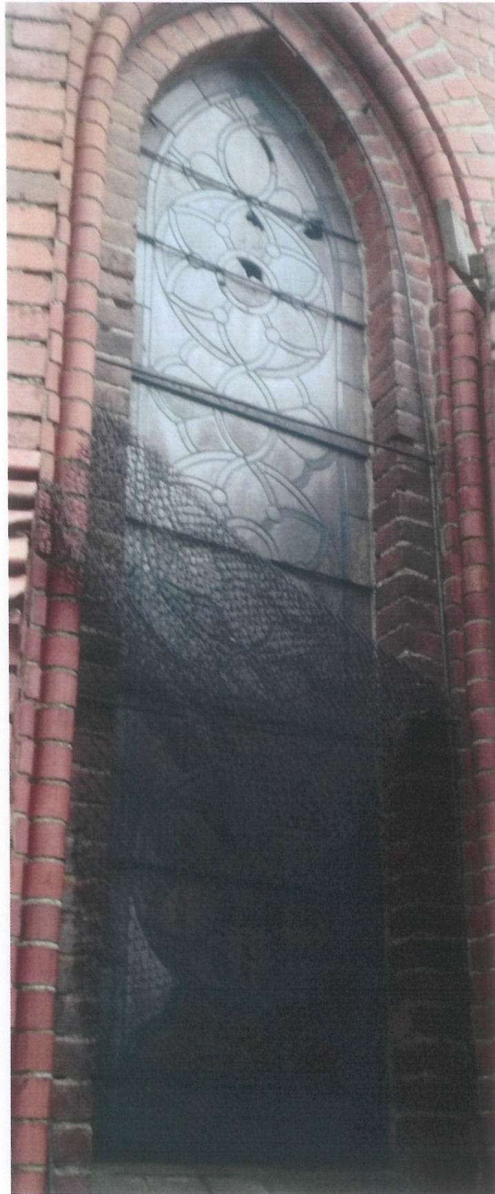
Fot. 123 (wyk. W. Tomaszewski): Stan zachowania witrażu z lewego okna prezbiterium (od zewnątrz).
