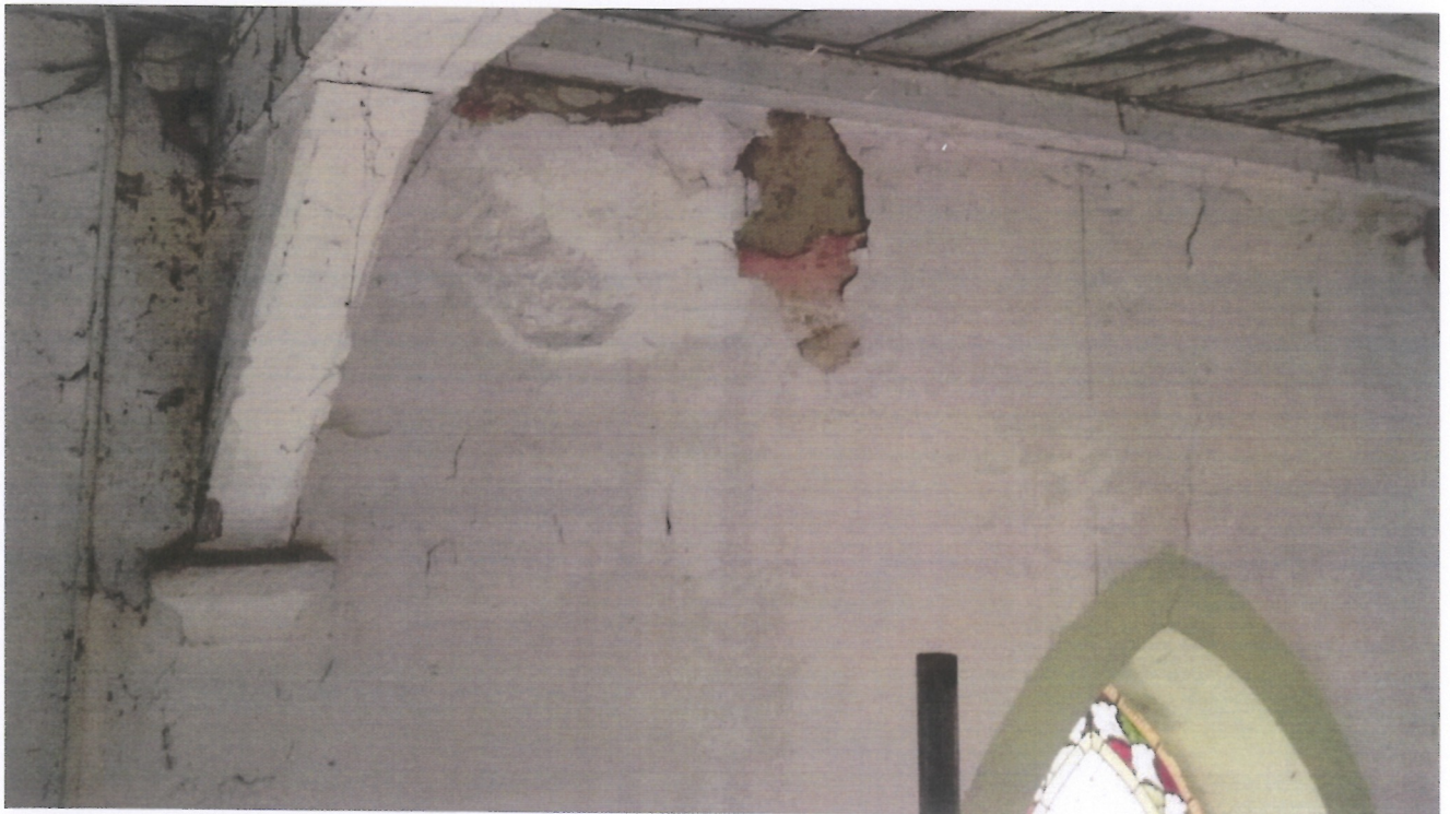
Fot. 80 (wyk. W. Tomaszewski): Widok stanu zachowania fragmentu powierzchni ściany południowej. Pod belką podtrzymującą deskowanie sufitu znajduje się samoczynnie odsłonięty fragment pozostałości dekoracji malarskiej.
