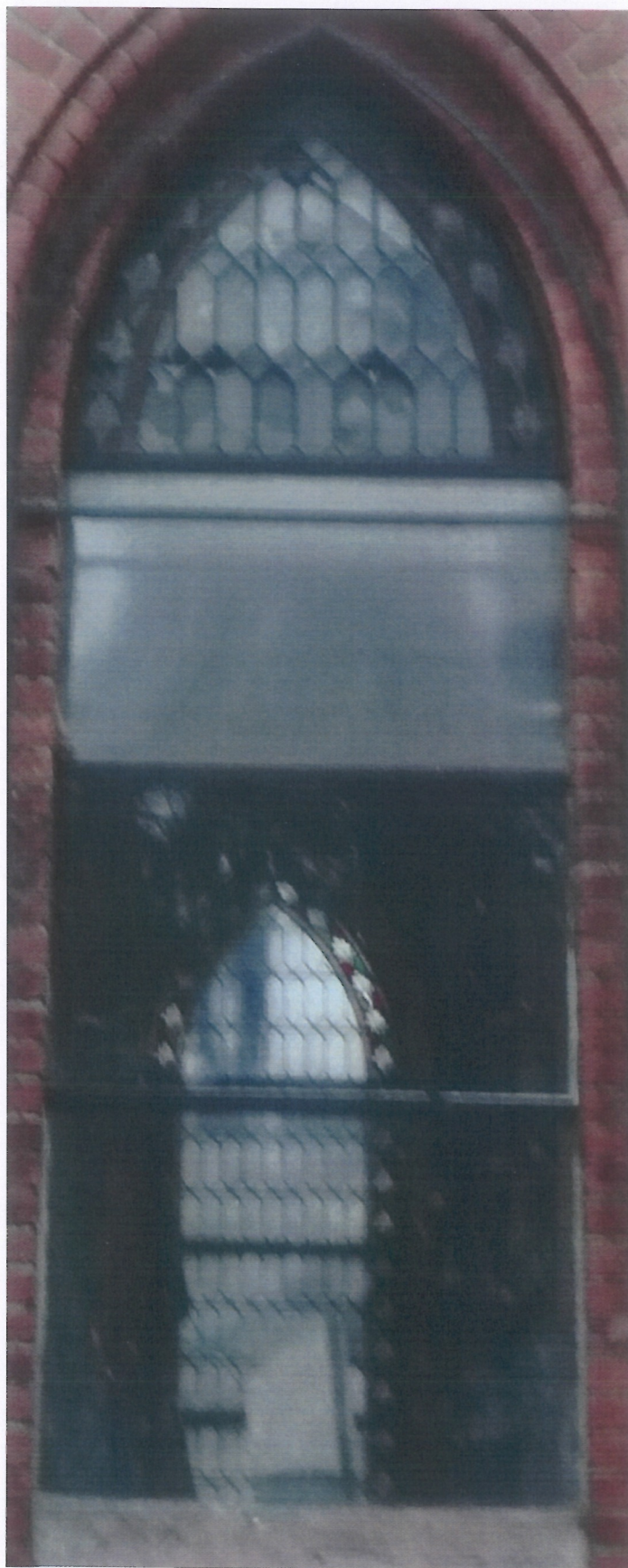
Fot. 133 (wyk. W. Tomaszewski): Stan zachowania witrażu w oknie na elewacji północnej (od zewnątrz).
