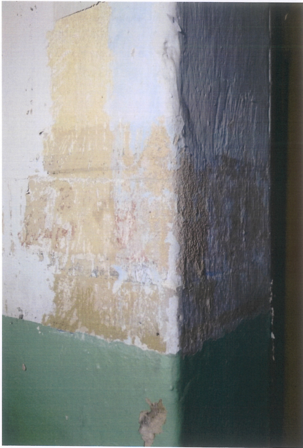
Fot. 86 (wyk. W. Tomaszewski): Odkrywka wykonana na ścianie wschodniej nawy (przy wyjściu do kruchty). Do wysokości ok. 150 cm namalowana jest lamperia z użyciem zielonej farby olejnej. Powyżej odstonięto odcinek dekoracyjnego pasa, który obecny jest na całym obwodzie ścian bocznych nawy.
