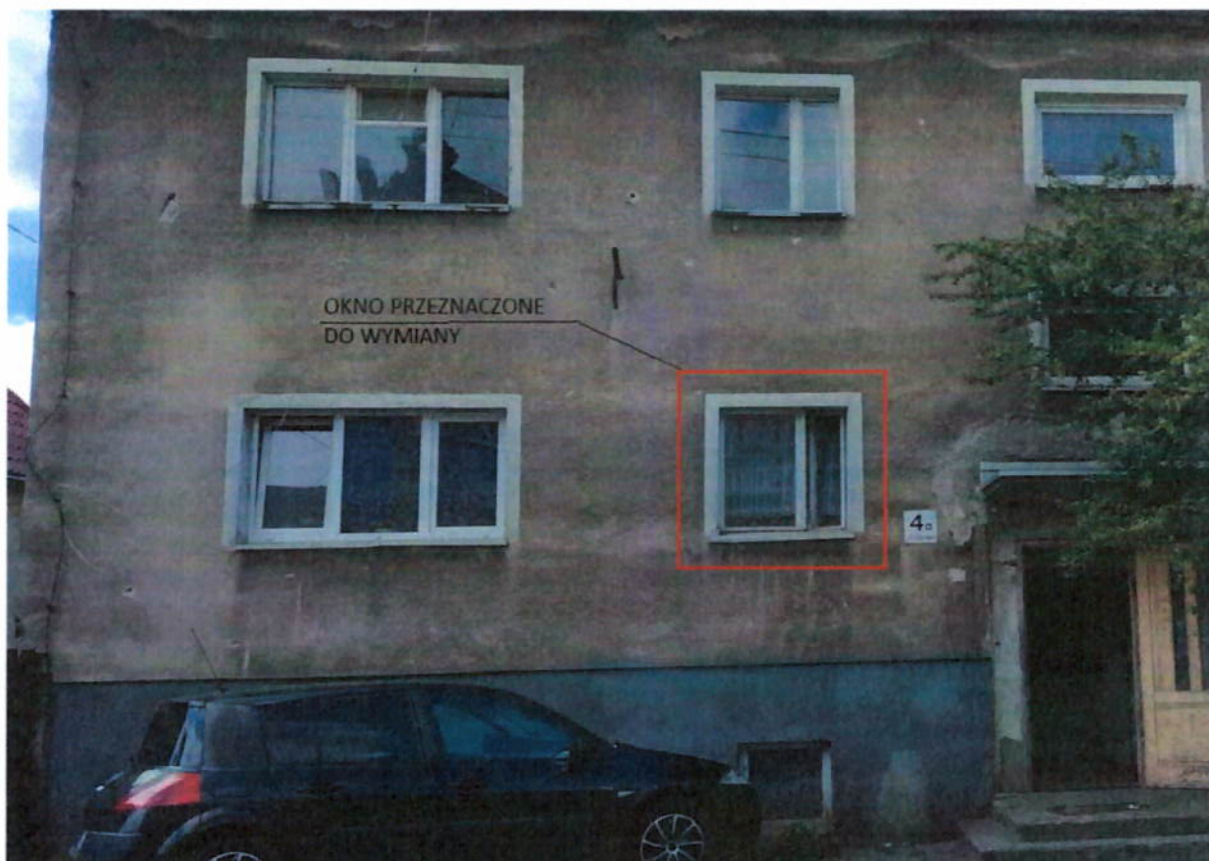
Fot. 1 – stolarka okienna przeznaczona do wymiany
