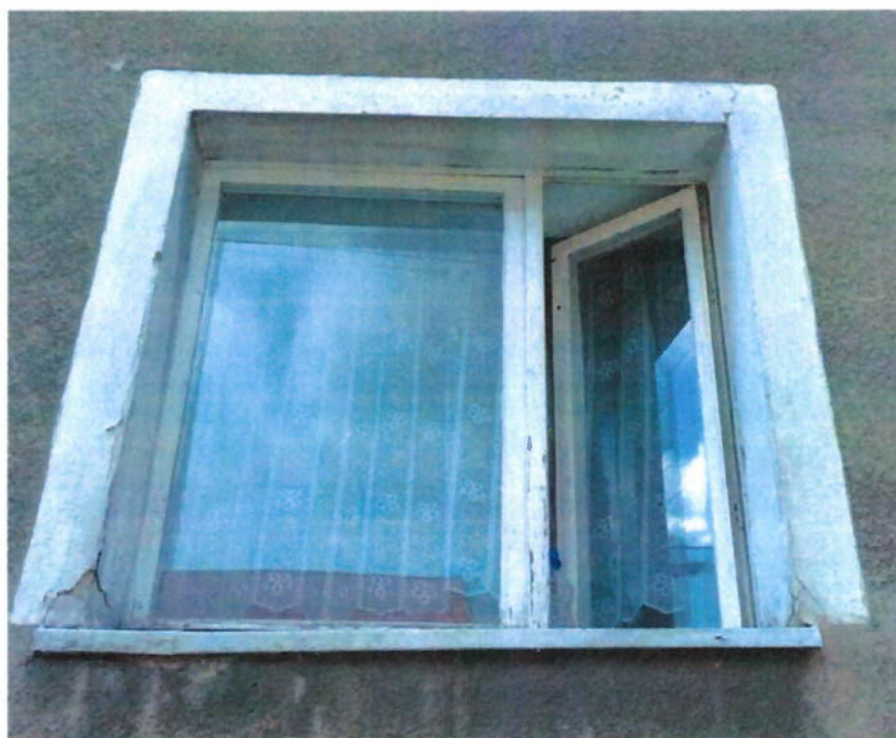
Fot. 2 – stolarka okienna przeznaczona do wymiany
