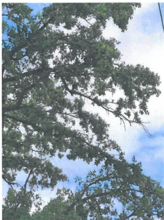
fot. 8 Susz nad jezdnią
