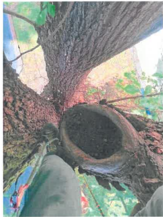
fot. 9 Ubytek na przewodniku SE na wys. 4 m
