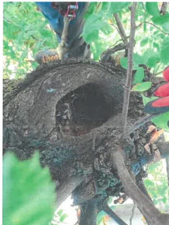
fot. 7 Ubytek na przewodniku SW na wys. 12 m
