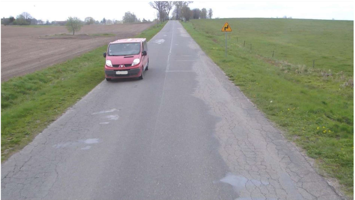
Rys. 6.1.2.3. Stan zły: spękania siatkowe i skupiska spękań zajmujące ponad 50% powierzchni [2]
