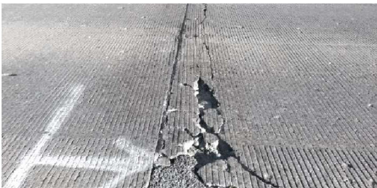
Rys. 6.2.5.1. Widok uszkodzeń z powodu nieprawidłowej pracy dybli
