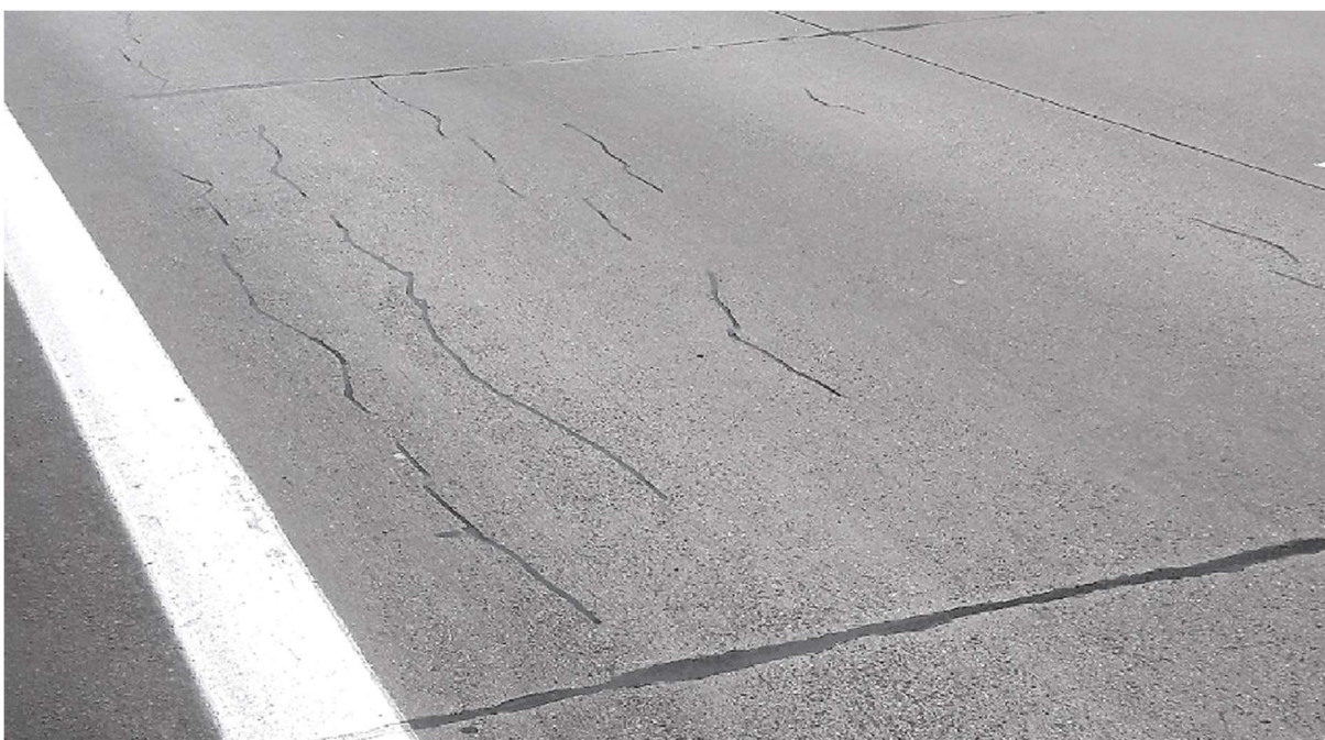
Rys. 6.2.2.3. Widok krótkich pęknięć podłużnych
