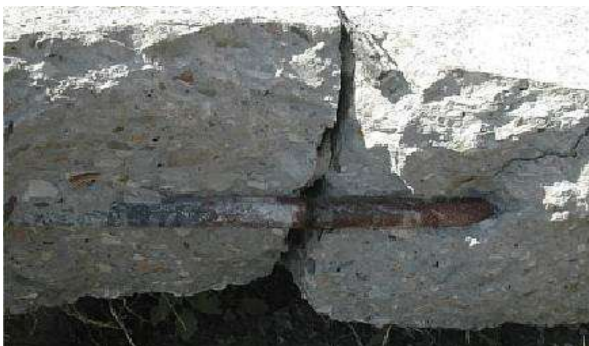
Rys. 6.2.5.2. Widok uszkodzeń z powodu nieprawidłowej pracy i korozji dybli
