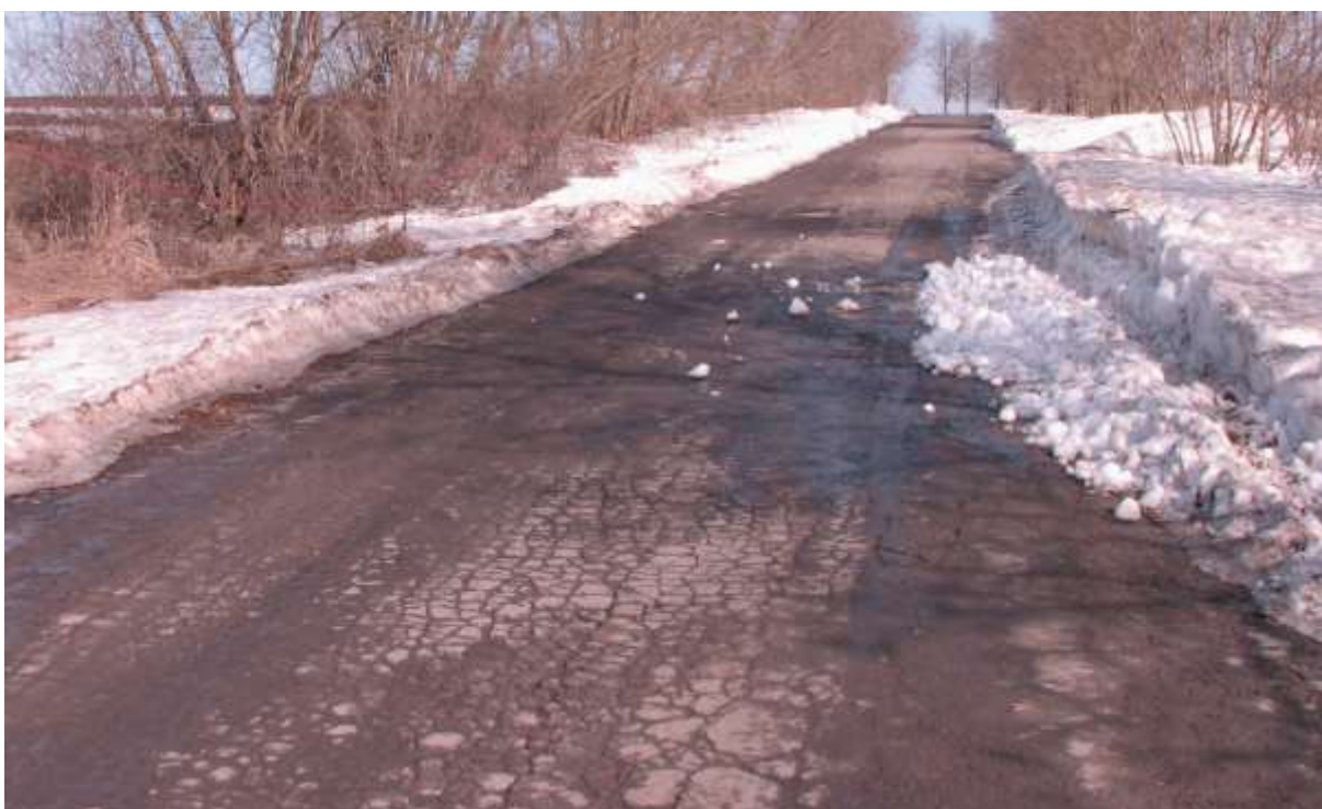
Rys. 6.1.2.13. Stan zły: spękania termiczne zmęczeniowe (blokowe) zajmujące powyżej 50% powierzchni
