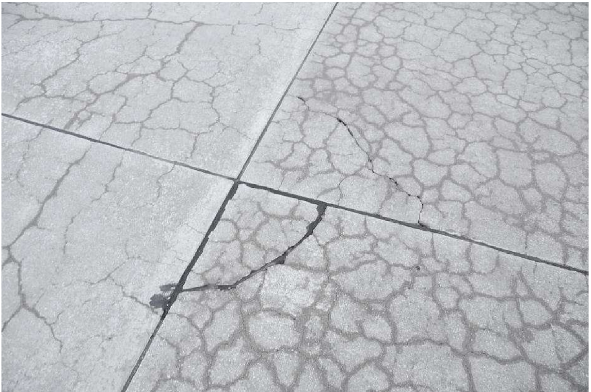
Rys. 6.2.3.5. Widok pęknięć alkalicznych
