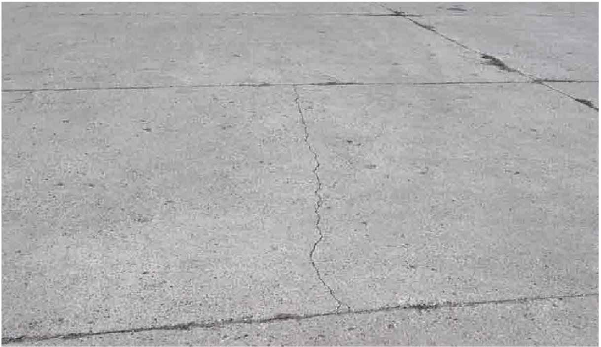
Rys. 6.2.2.5. Widok pęknięć poprzecznych
