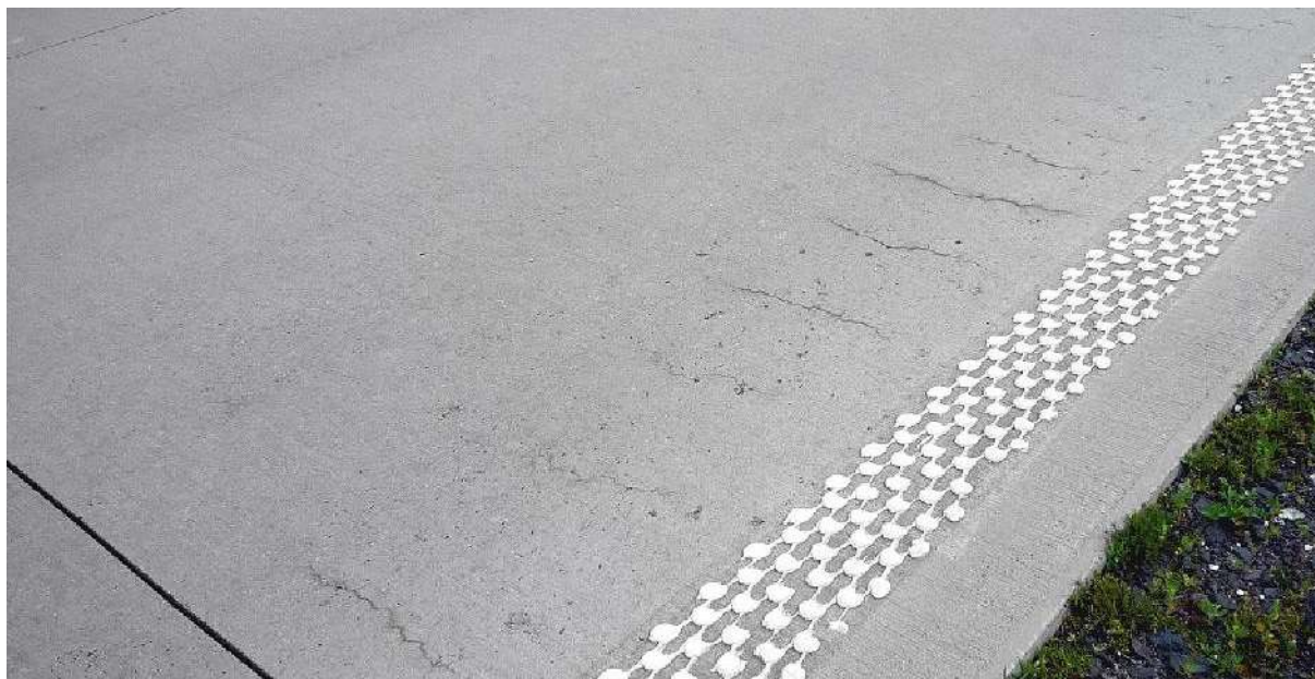
Rys. 6.2.3.7. Widok pęknięć spowodowane niewłaściwą pielęgnacją
