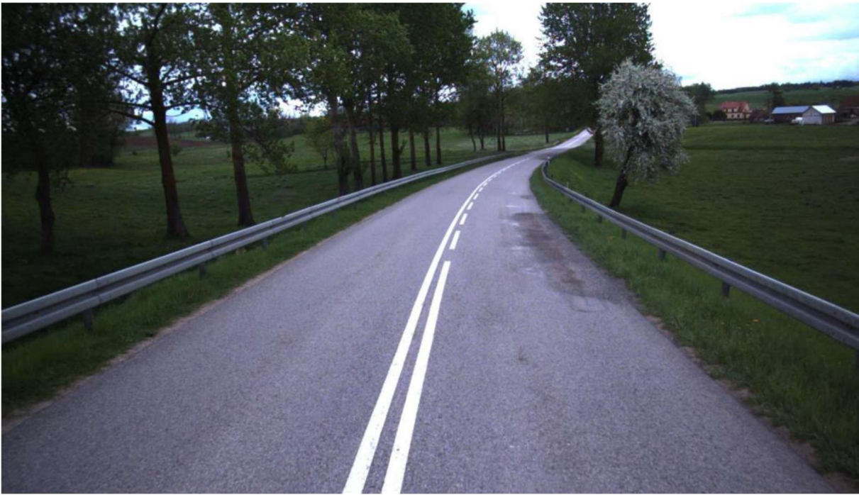
Rys. 6.1.3.5. Stan niezadawalający: łaty zajmujące do 20% powierzchni [2]
