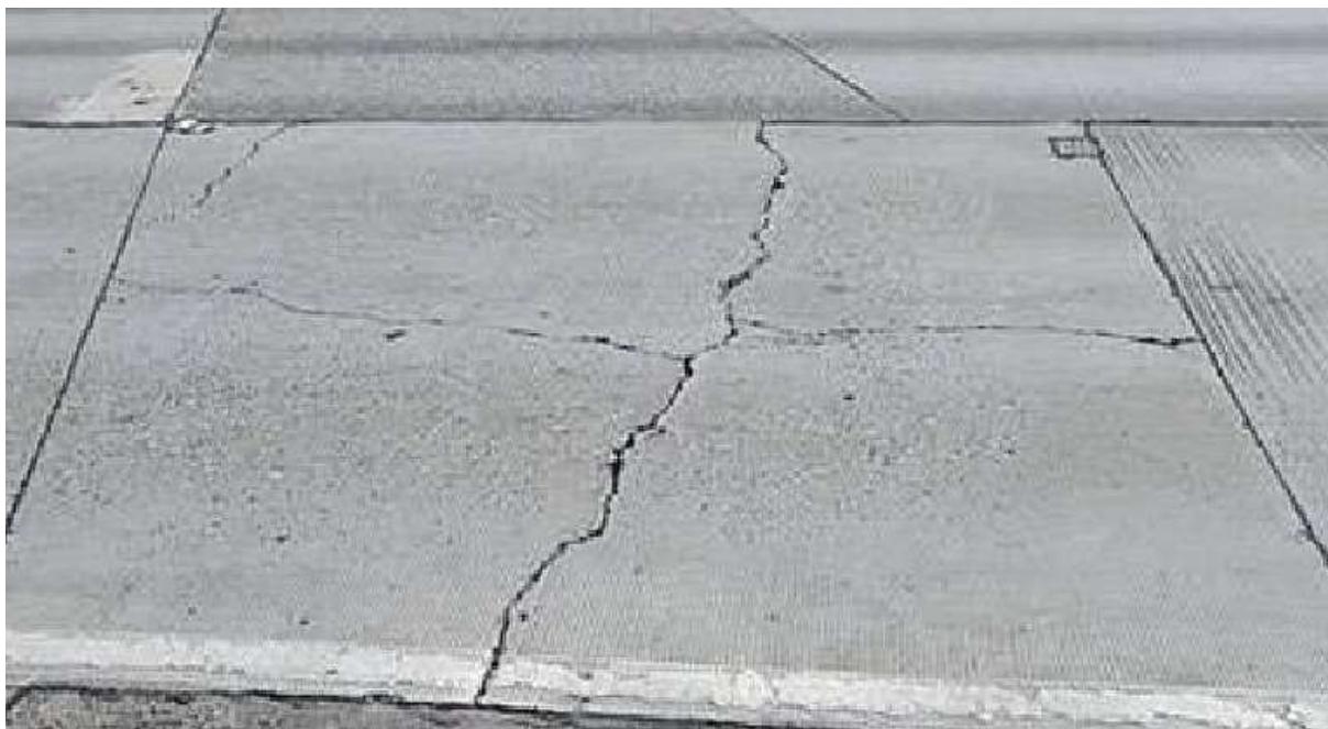
Rys. 6.2.2.10. Widok pęknięć blokowych
