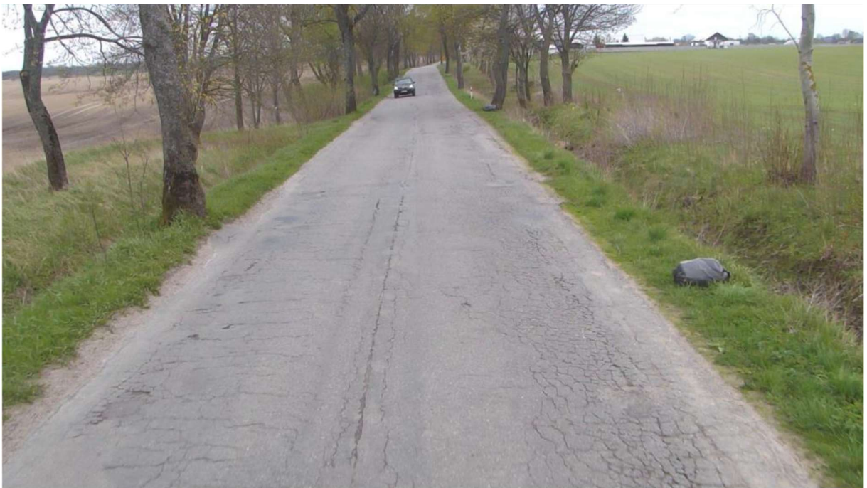
Rys. 6.1.2.4. Stan zły: spękania siatkowe zajmujące ponad 50% powierzchni [2]
