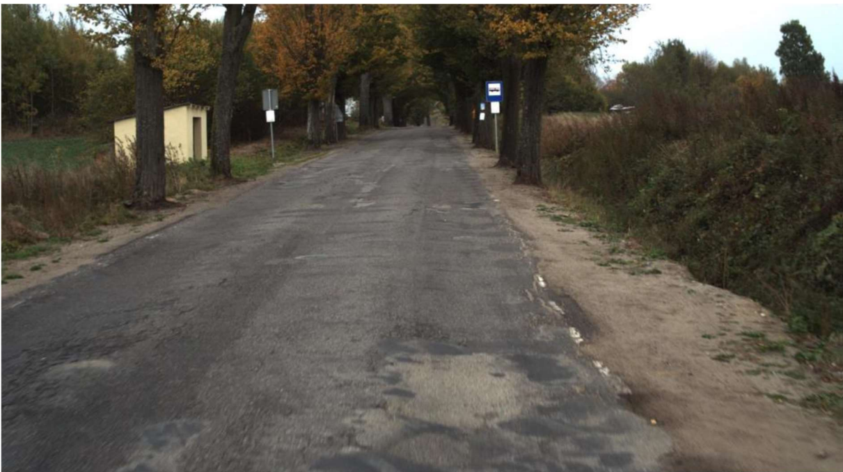
Rys. 6.1.1.5. Stan zły: liczne uszkodzenia zajmujące powyżej 50% powierzchni – nawierzchnia mocno skoleinowana [2]
