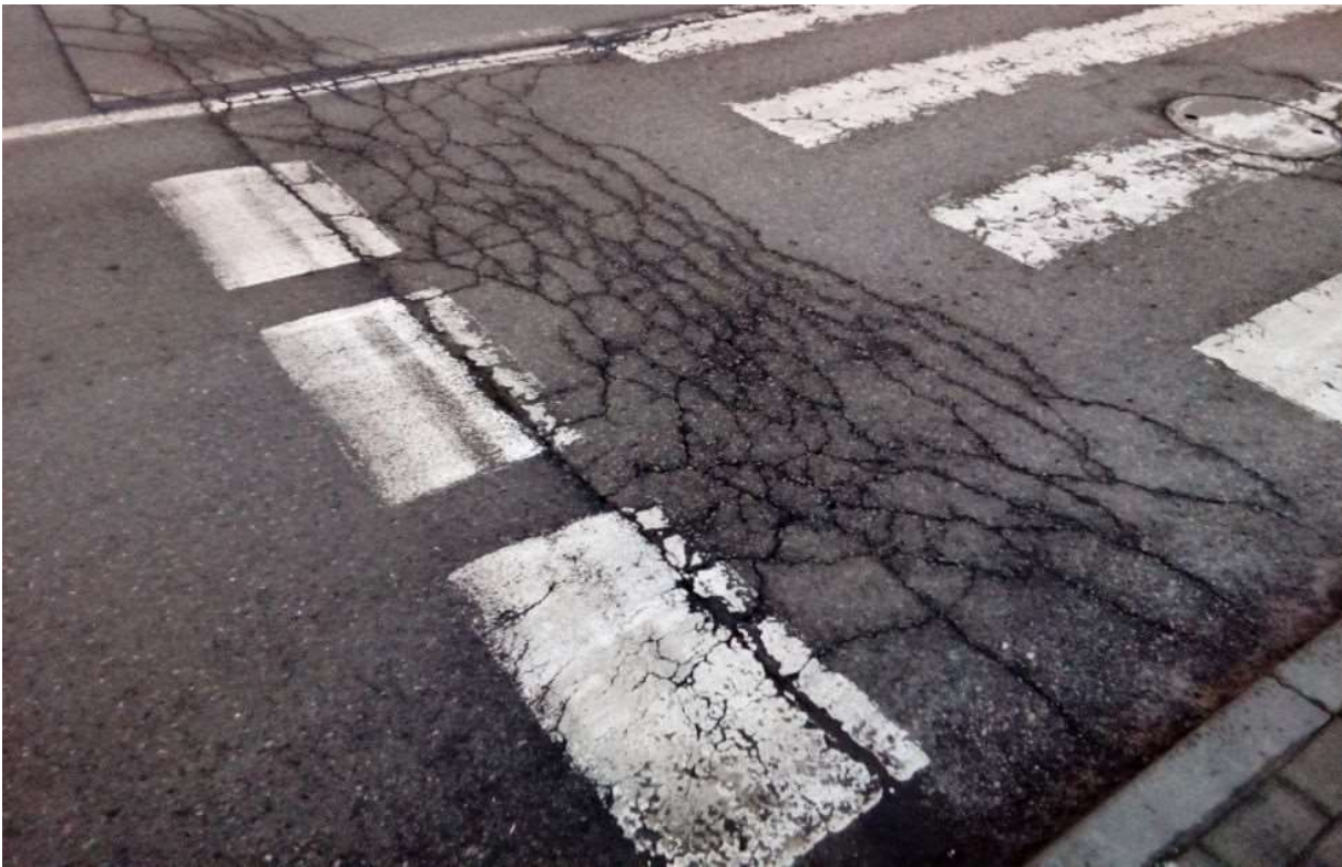
Rys. 6.1.2.5. Przykład spękania zmęczeniowego przy połączeniu technologicznym
