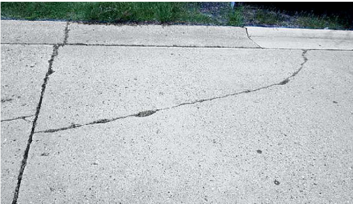
Rys. 6.2.2.8. Widok pęknięcia naroża z częściowym wykruszeniem
