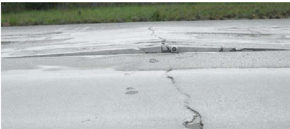
Rys. 6.2.1.4. Widok deformacji podłużnych na długości płyty
