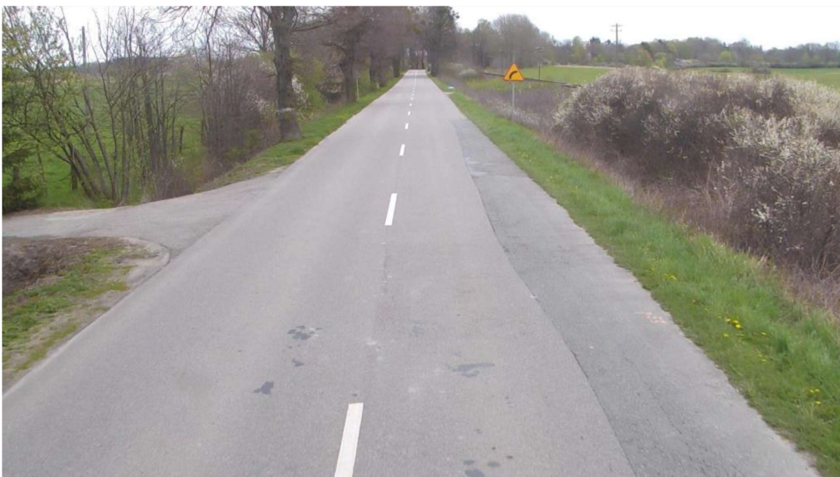
Rys. 6.1.3.4. Stan niezadawalający: łaty zajmujące do 20% powierzchni [2]
