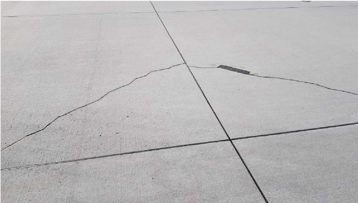
Rys. 6.2.2.7. Widok pęknięcia naroża
