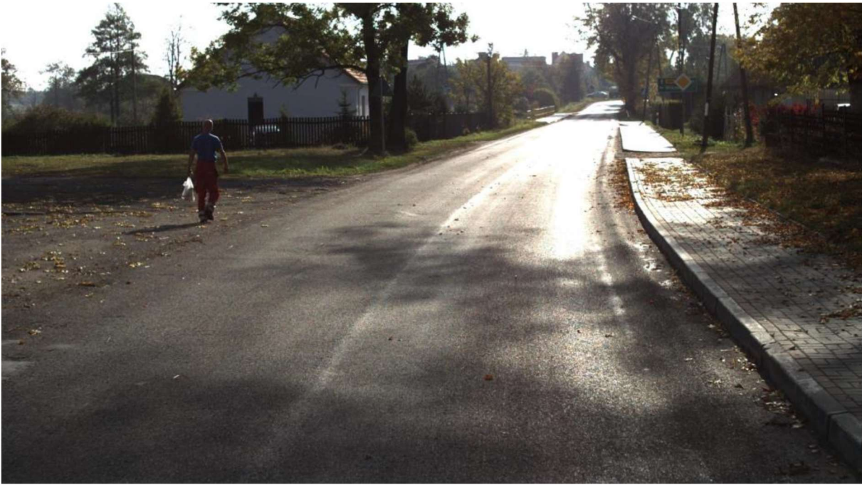
Rys. 6.1.1.4. Stan niezadowolający: widoczna deformacja w śladzie prawego koła – uszkodzenia zajmujące powyżej 10% powierzchni [2]
