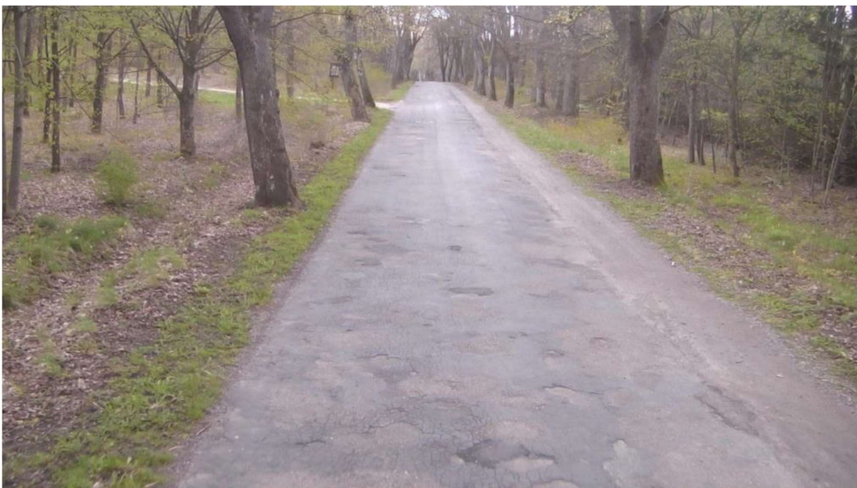
Rys. 6.1.3.7. Stan zły: liczne wyboje – powyżej 50% powierzchni [2]
