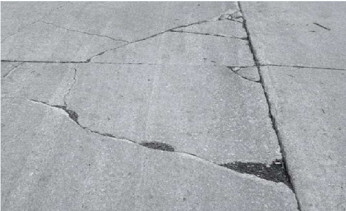
Rys. 6.2.2.1. Widok pęknięć blokowych w obszarze naroża
