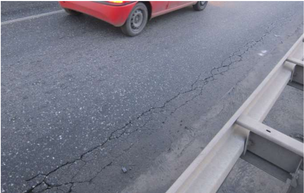
Rys. 6.1.2.7. Spękania zmęczeniowe podłużne (w śladzie nierówności poprzecznej)
