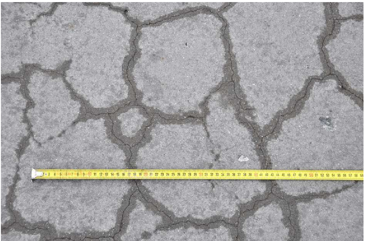
Rys. 6.2.3.6. Widok pęknięć alkalicznych
