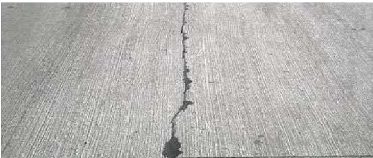
Rys. 6.2.2.2. Widok pęknięcia podłużnego na długości płyty
