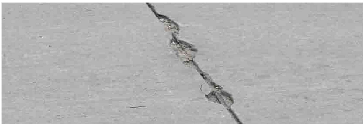
Rys. 6.2.4.1. Widok uszkodzenia szczeliny płyty
