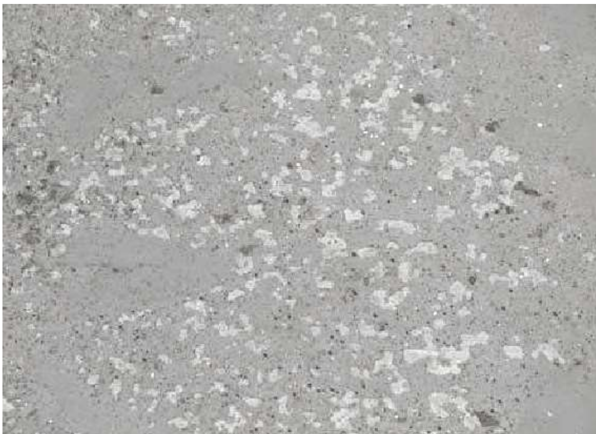
Rys. 6.2.3.10. Widok ubytków ziaren/lejków
