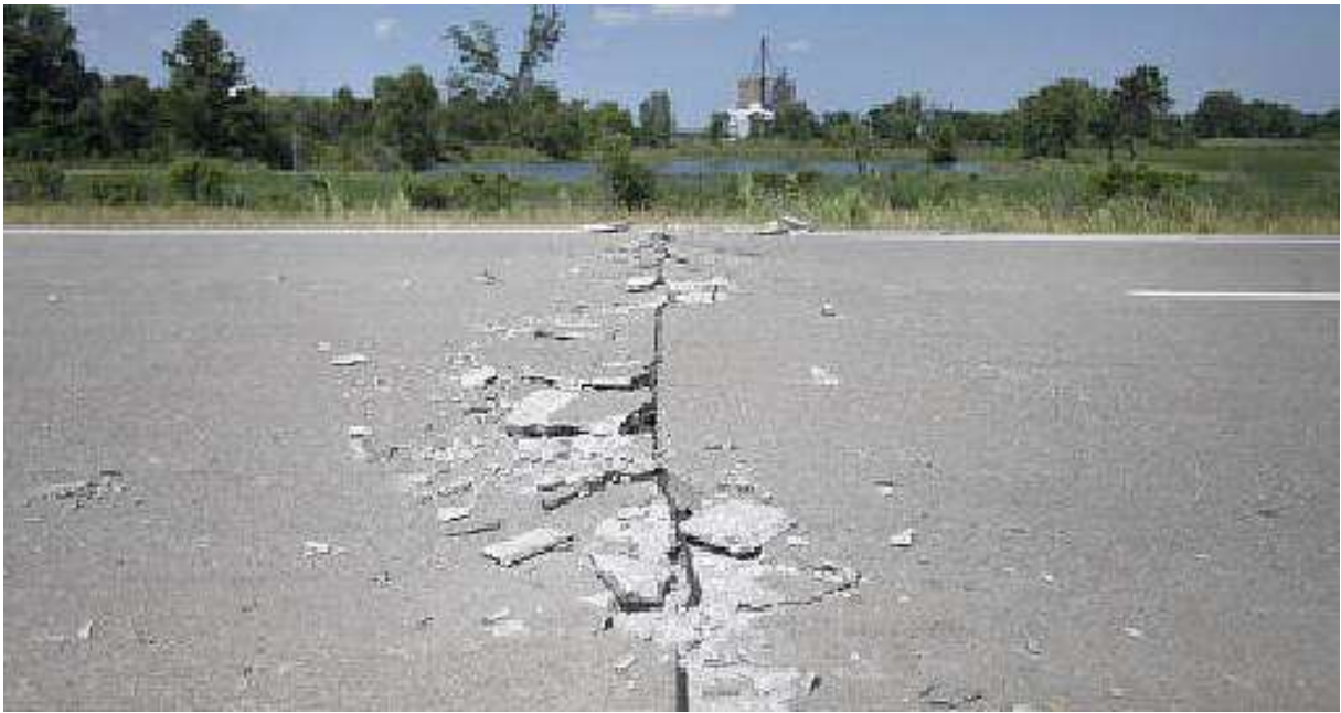
Rys. 6.2.4.2. Widok uszkodzenia szczeliny płyty
