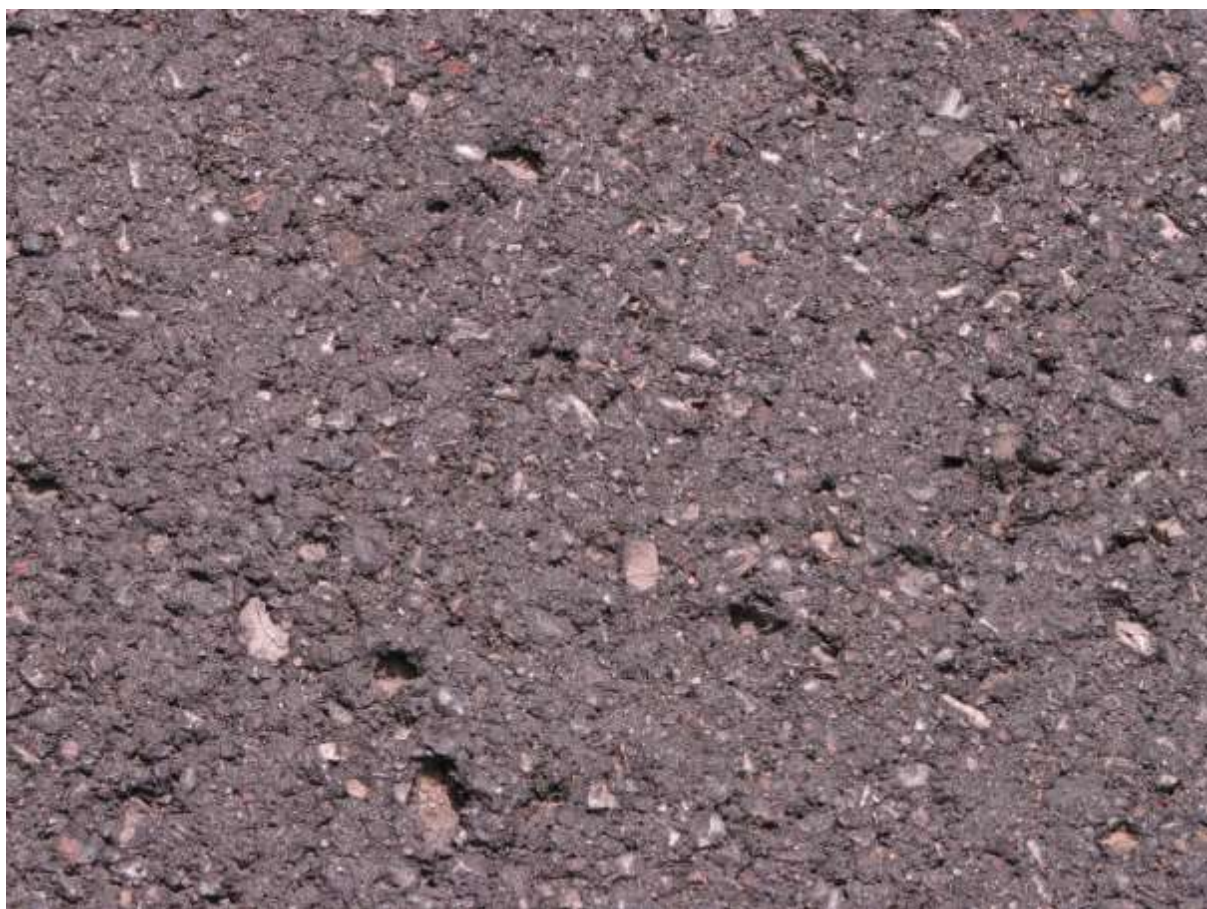
Rys. 6.1.3.1. Ubytki ziaren kruszywa i lepiszcza oraz mieszanki mineralno-asfaltowej
