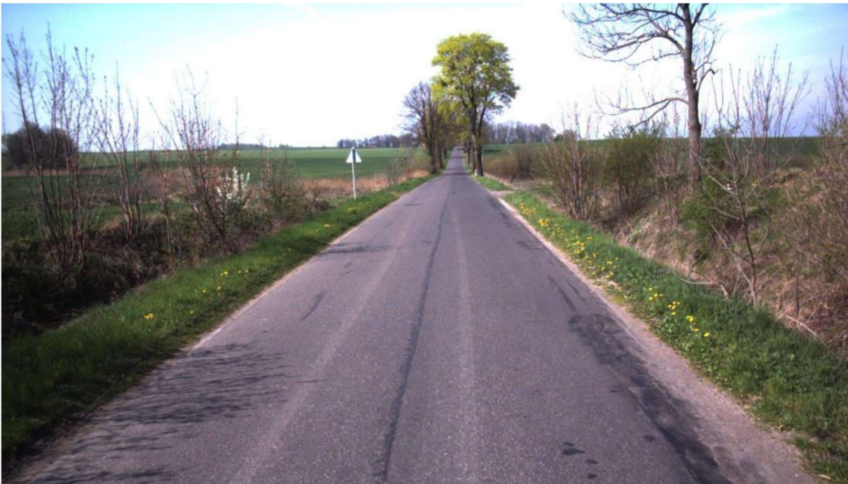
Rys. 6.1.3.6. Stan niezadawalający: łaty oraz spękania zajmujące do 20% powierzchni [2]
